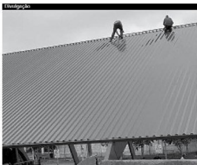
Flagrante da falta de EPI dos operários na obra
